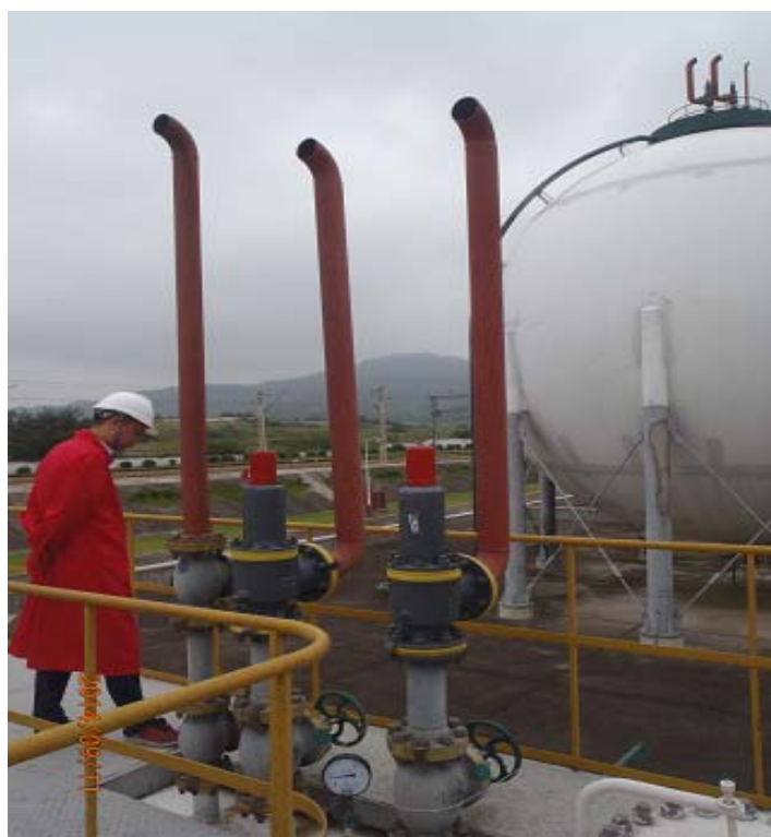
图 储罐顶安全阀
