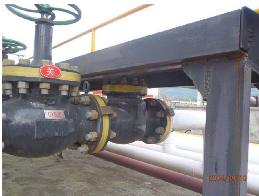
图 储罐液相进口管线止回阀
